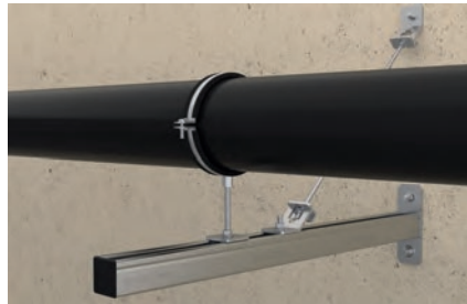
Крепление тяжелого трубопровода с помощью консоли
