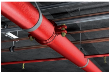
Системы аварийного пожаротушения
