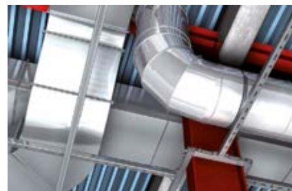
Опорные конструкции для крепления вентиляции
