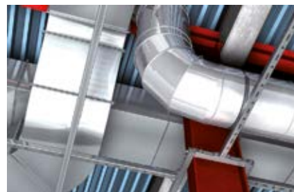
Опорные конструкции для крепления вентиляции
